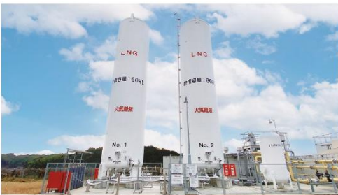
LNGサテライト
