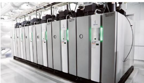
小型貫流蒸気ボイラー
